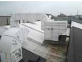
塗装ブース排気ダクト
