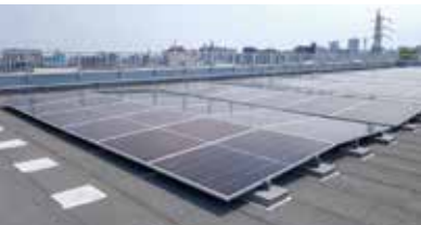
本社本館屋上にソーラーパネルを設置するなど、積極的に再生エネルギーの活用に取り組んでいます
