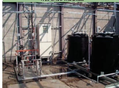
消臭剤供給装置
