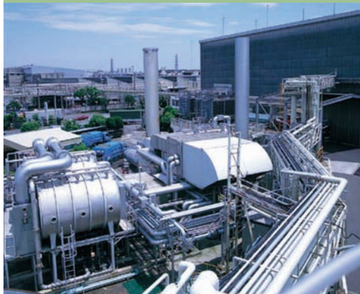
第1地区のコ・ジェネレーションシステム
