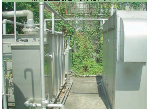
第3地区土壌地下水浄化プラント
