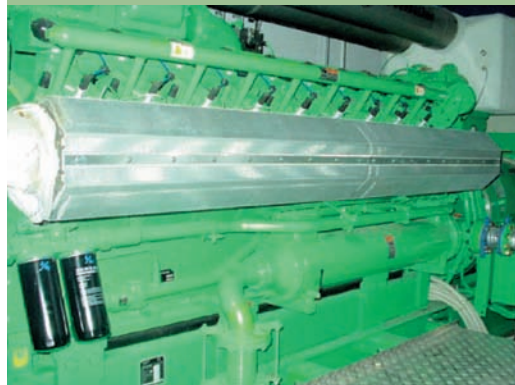
テクノセンターのコ・ジェネレーションシステム
