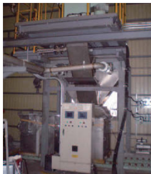
塗料汚泥回収設備
